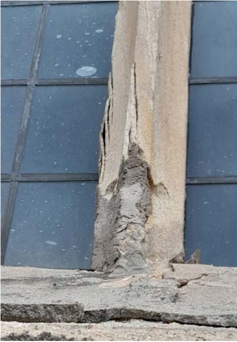
Diese Mittelstrebe des Kirchenfensters muss dringend instand gesetzt werden, damit die Scheiben halten.
